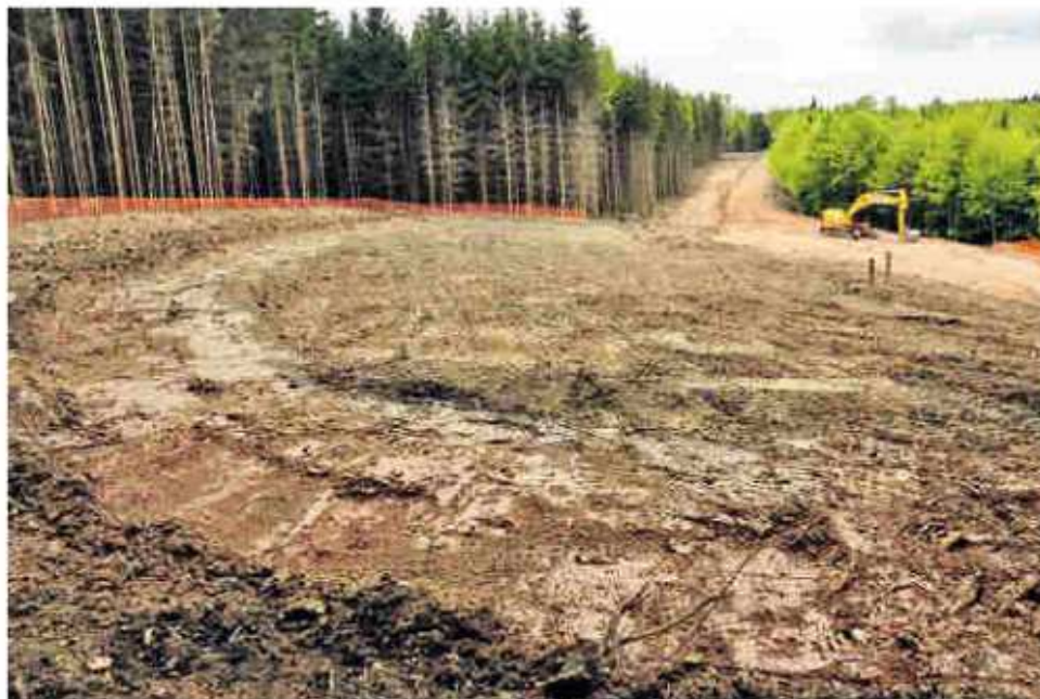
Die Waldflächen sind gerodet worden, nun entstehen die Fundamente für die ersten sechs Anlagen im künftigen Windpark im Stadtwald Mengersinghausen.
