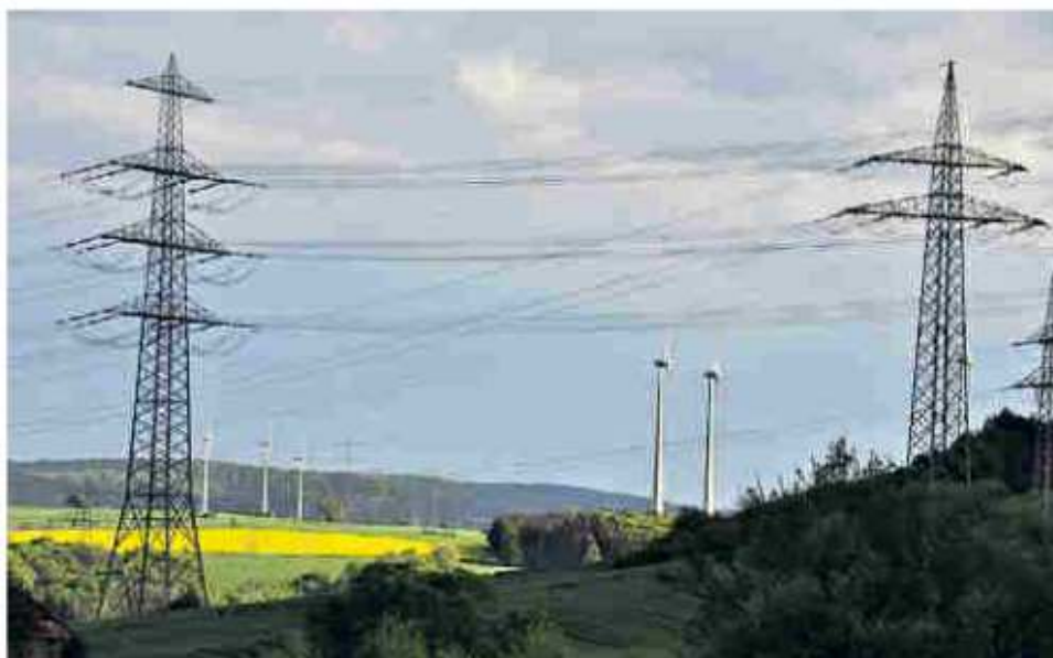
Vom Weg an der Matzenhöhe lassen sich gut die Windkraftanlagen in Twistetal und die Starkstrommasten am Umspannwerk erkennen.
